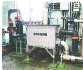
放流水監視槽
