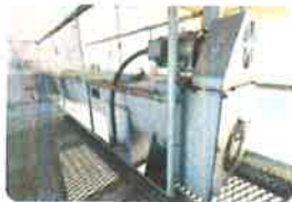
汚泥搬出装置
